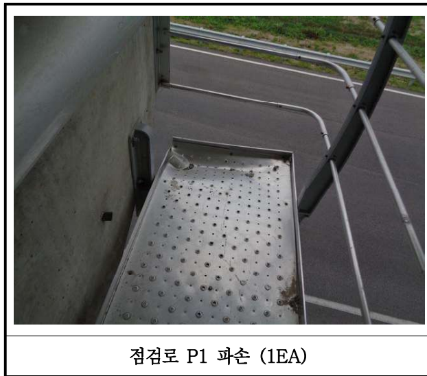
【사진 42.3.26】 교량 점검시설 손상현황
