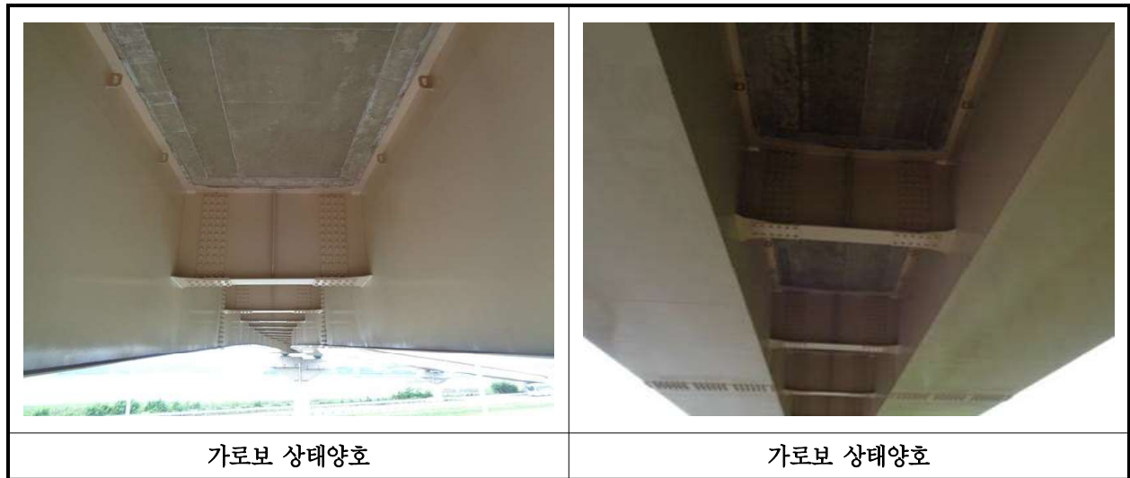
【사진 42.3.7】 가로보 손상현황
